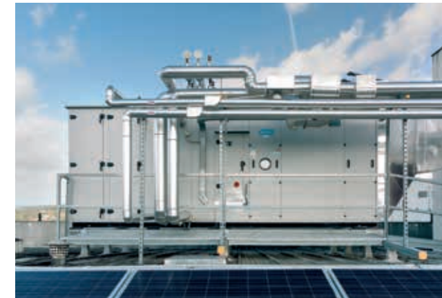
Bild 23: Exempel på en installation utomhus
